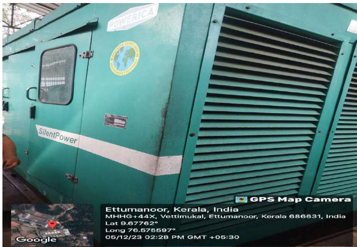
DG Set (380 KVA)
